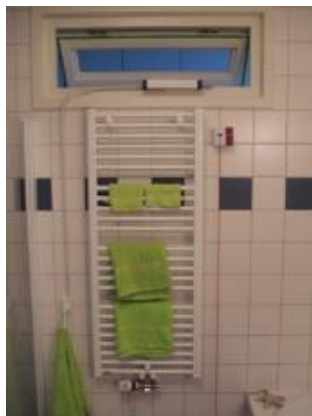
Afbeelding 4: Een radiator in de badkamer
